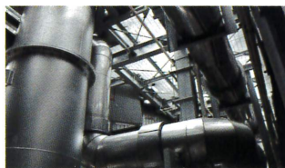
プラント配管
